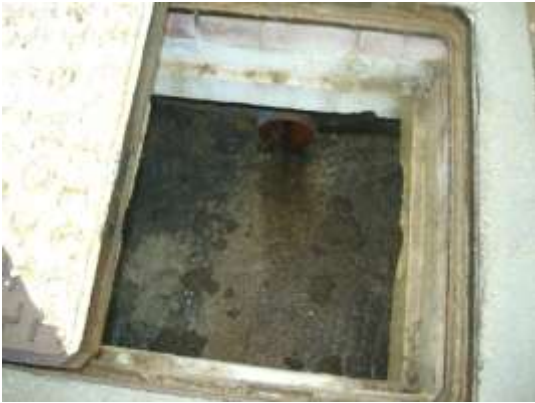
FOTO 4 Arrivo pozzetto acque di prima pioggia.
