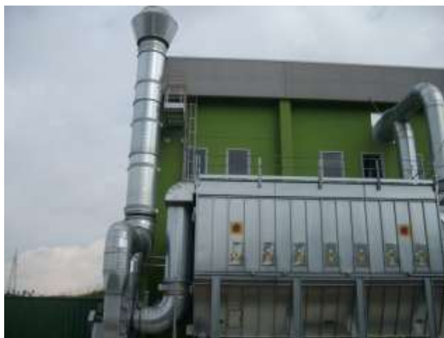
FOTO 23: filtro a maniche e camino E5.
