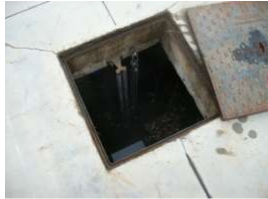
FOTO 5: vasca di sedimentazione acque di prima pioggia. 21/09/2012
